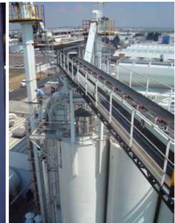
Banda transportadora de material
