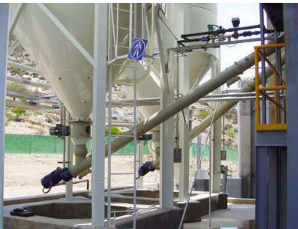
Silo de almacenamiento conectado a tornillos helicoidales para transporte mecánico
